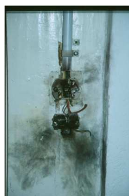
Fig 4 : prise de courant détruite
