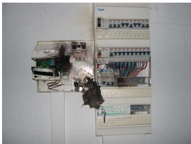
Fig 6 : disjoncteur principal et compteur détruits
