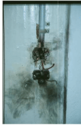
Fig 4 : prise de courant détruite
