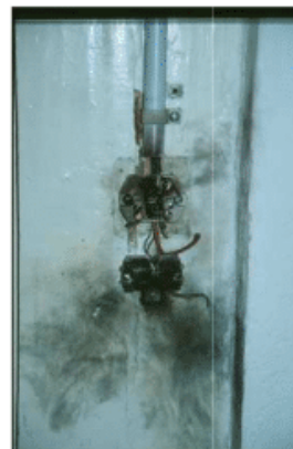
Fig 4 : prise de courant détruite
