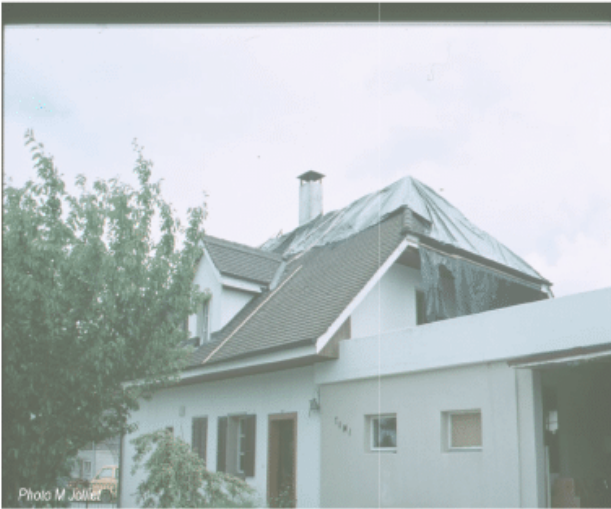
Fig 1 : une partie de la toiture est détruite par l'incendie
